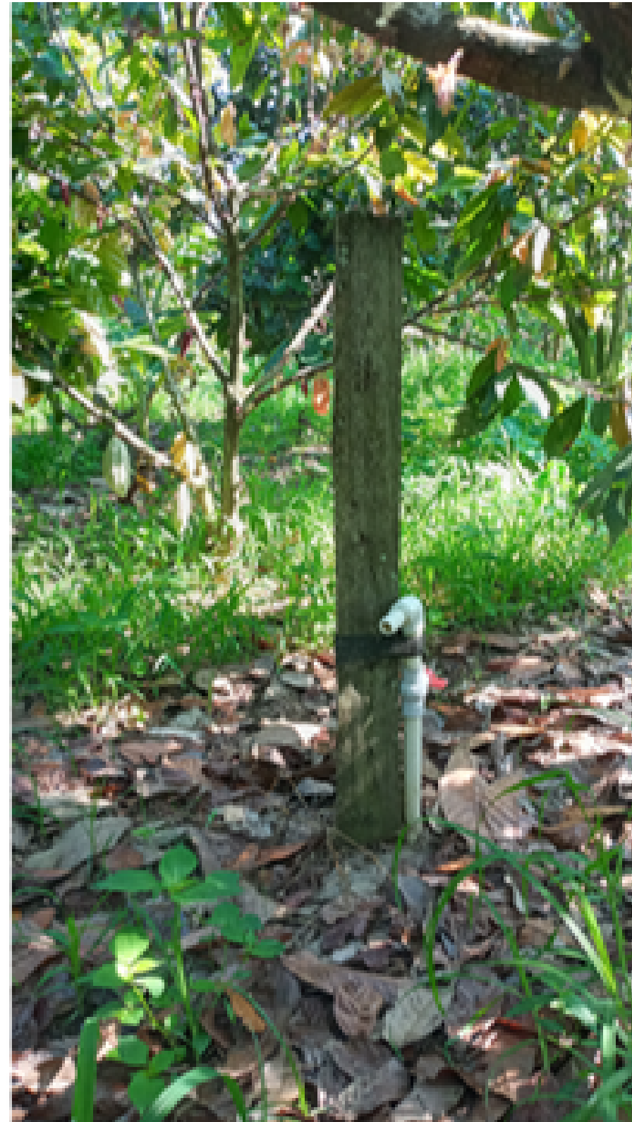
Hidrantes de agua
